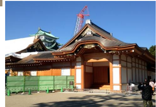
名古屋城?! 内外仕上げはもとより、 仮設から場内加工場・見学ルート等、 隅々まで行き届いた復元工事現場! 各所に最新技術・伝統技術を垣間見ることができます。
